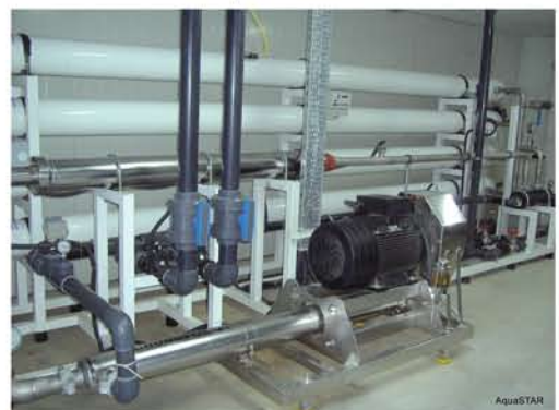
Sealight Otel / Kusadası • Capacity 600m 3 /day
